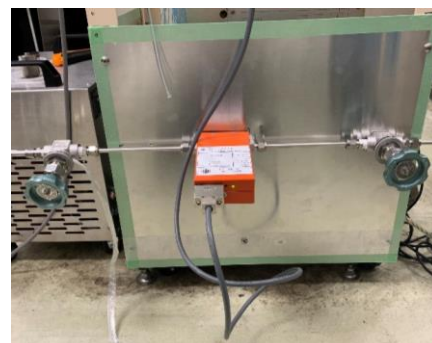
図2 マスフローコントローラーの設置状況
